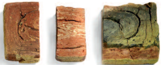
Mauerstein, mit Schneckenpresse hergestellt. Durch den Schichtaufbau des Tons sind Frostschäden entstanden.
